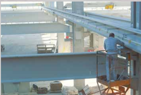
Trabajando a gran altura. Las plataformas elevadoras funcionaban por todas partes, para colocar las traviesas de las grúas, donde más tarde serían necesarias.
